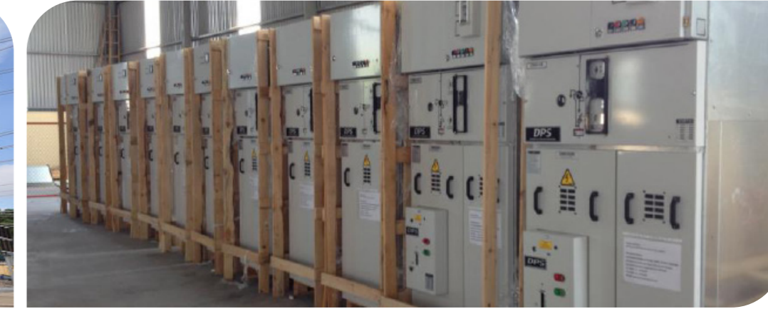
TRẠM 35KV QUẢNG LĨNH
